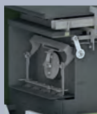
Serranda gas di scarico chiusa
